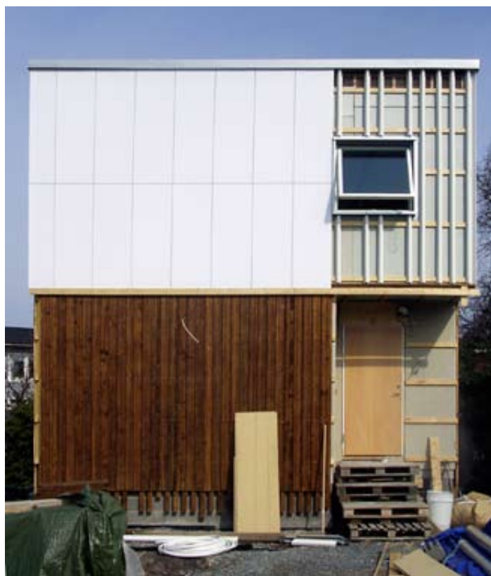
Unit arkitektur tejgade samman akrylplastskivor, plexiglas, på en villa i Göteborg. Bottenvåningen är av trä målad med ”bryggsmörja”.
